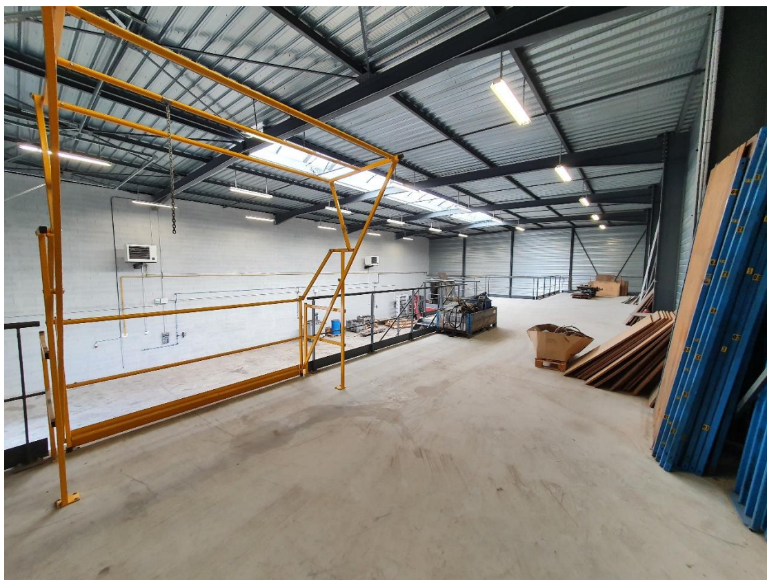
Figure 10: Partie EST / Mezzanine sécurisée et barrière basculante de sécurité / 30m x ≈6m ≈ 150m 2
